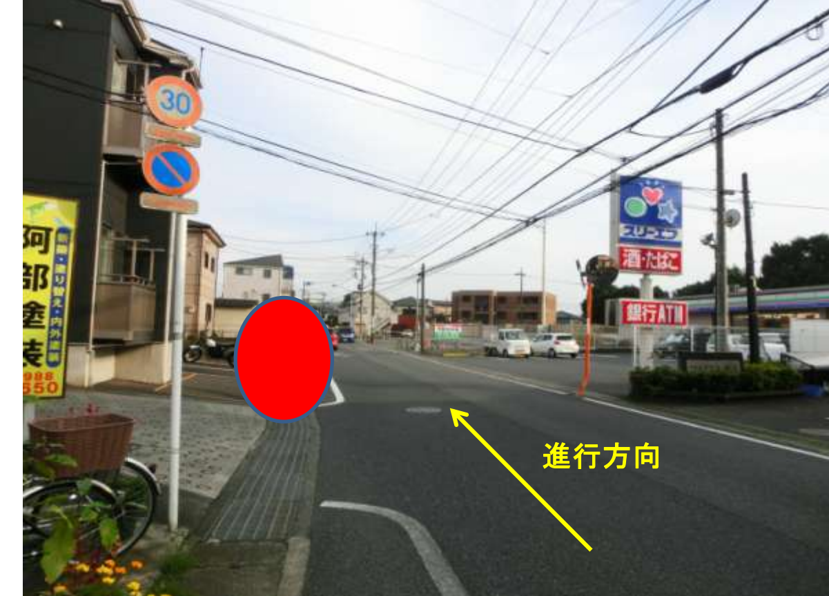
※ 現在工事中につき分かりにくくなっています ⑧スリーエフ(改装中)向かい (下麻生2丁目) 工事中
